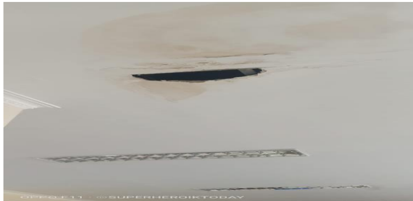
Gambar 4. Kondisi Plafon Berlubang
