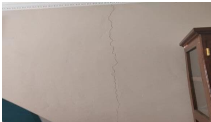
Gambar 3. Kondisi Dinding Retak
