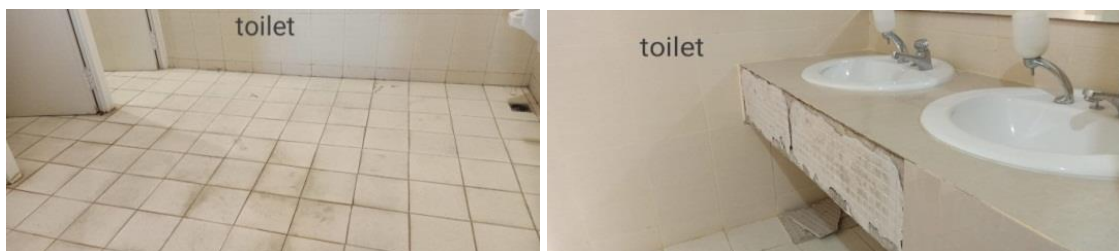
Gambar 5. Lantai Toilet Licin Dan Retak
